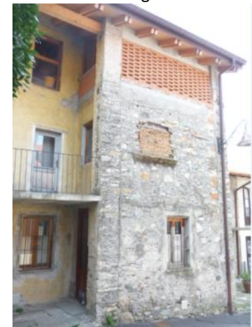
Sopralzo di muratura con graticcio di mattoni e tamponamenti estranei alla tecnica in pietra. Anche in questo caso la muratura va intonacata.
