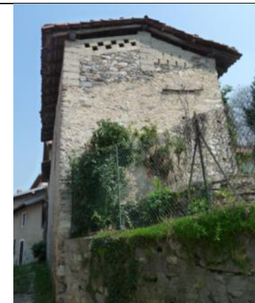
Sopralzo di muratura realizzato con blocchetti di cemento lasciato a vista. Tale soluzione tecnica e compositiva è estranea alla tradizione. In questi casi la parete deve essere obbligatoriamente intonacata.
