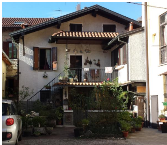
Pur mantenendo il sedime originario, le strutture di copertura dell'edificio risultano modificate e incoerenti con la matrice del Centro Storico.
