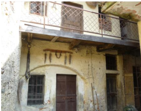
Balcone a ringhiera. Struttura lignea originaria ma utilizzo di ringhiera non conforme ai tipi tradizionali.
